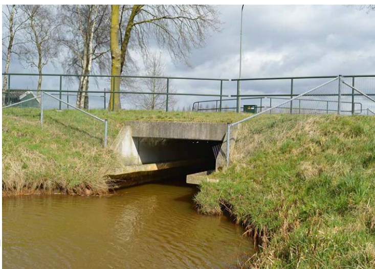
Loopplank met aansluitende rasters
