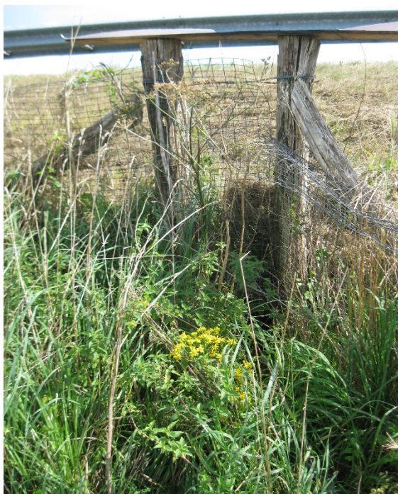
Figuur 3: Het dwarsraster is beschadigd.
