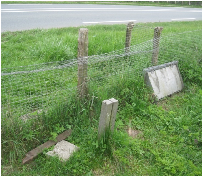
Figuur 3: Het raster aan de noordzijde t.h.v. het ontsnappingspoortje is beschadigd.
