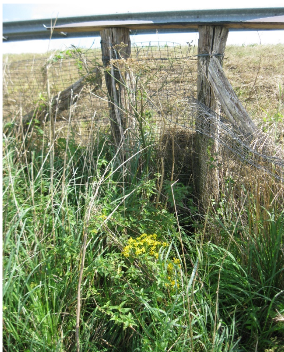
Figuur 3: Het dwarsraster is beschadigd.
