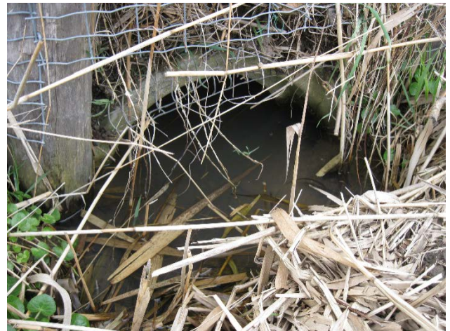
Figuur 3: De Faunatunnel stond tijdelijk onder water.
