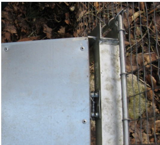
Figuur 2: Constructiefout dassenpoortje
