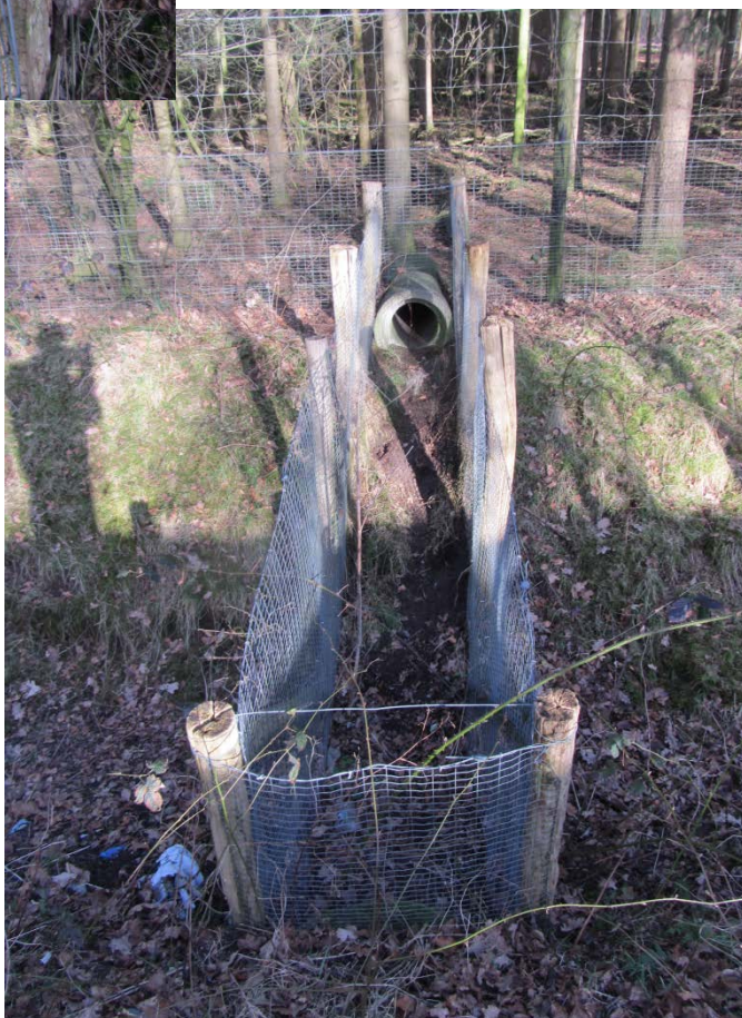
Figuur2 (rechts): Opening oostzijde met doorvoer door combiraster.
