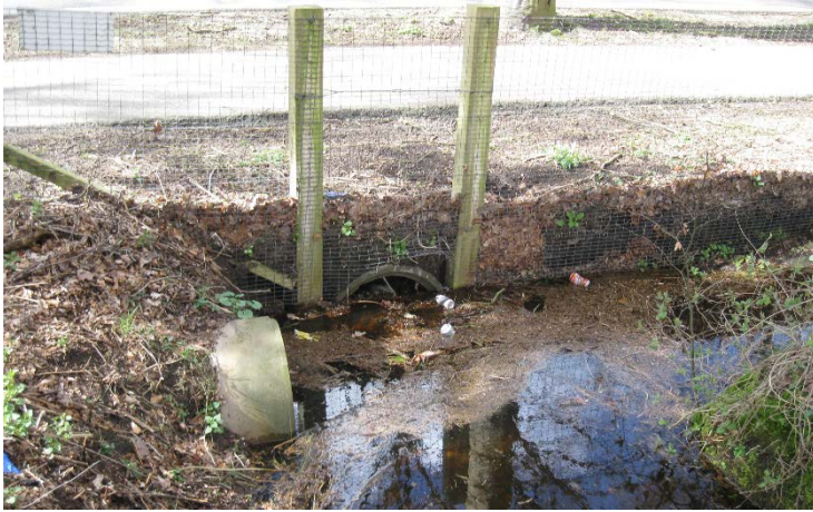
Figuur 1 (links): De faunatunnel (westzijde) in het voorjaar onder water.
