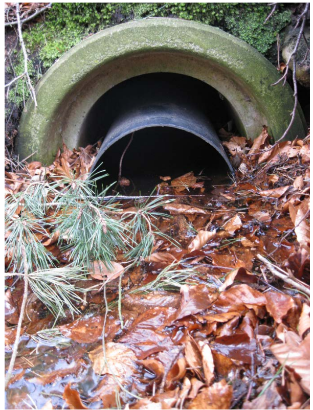
Figuur 2: PVC buis gebruikt voor herstel is nog aanwezig. De ingang is volgelopen water.
