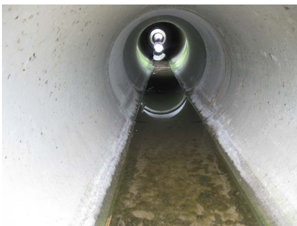
Figuur 3: In 2/3 van de tunnel staat ca 10 cm water.
