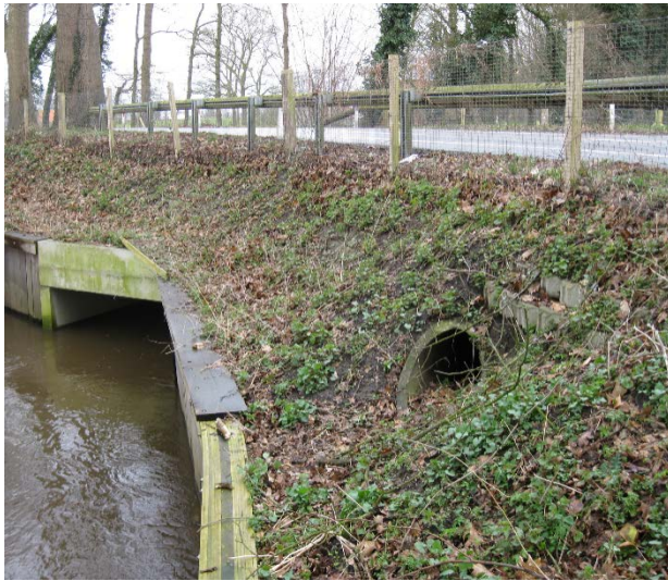
Figuur 1: De faunatunnel met opening westzijde, loopt parallel met de Willinksbeek.
