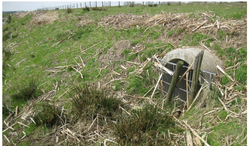
Figuur 2: Opening zuidzijde met blokkade.
